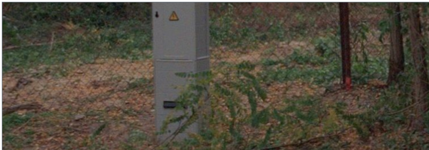
Obrázek: elektrické vedení
